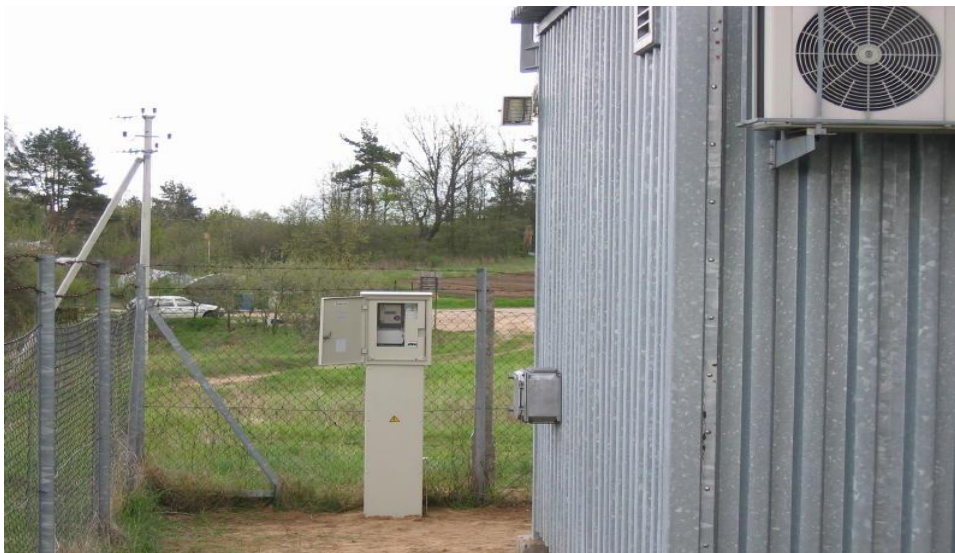
Расположение стойки учета электроэнергии на территории приема – передающей системы провайдеров мобильной связи
